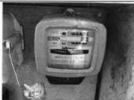
Photo du Compteur électrique
